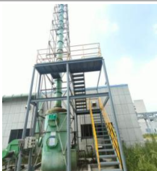
固废仓库废气处理设施
