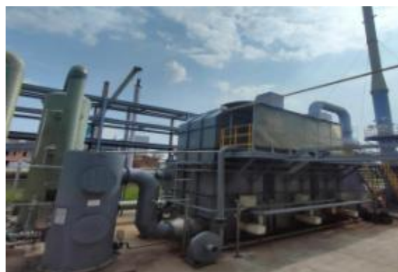
RTO 废气焚烧系统
