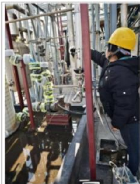
N#罐区无机废气排气筒出口
