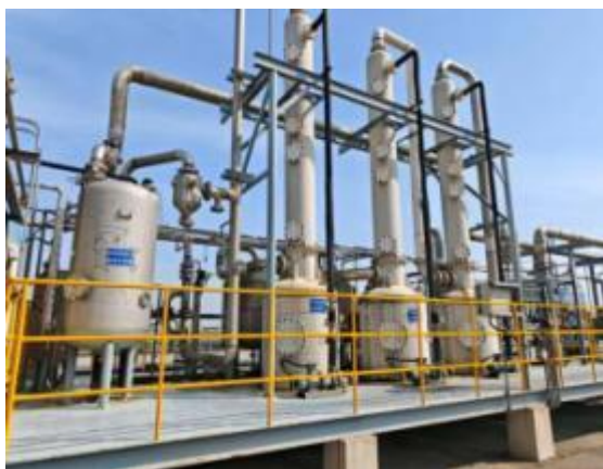
803 车间有机废气预处理设施
