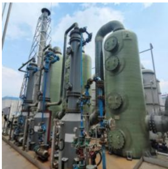
802 车间酸性废气处理设施
