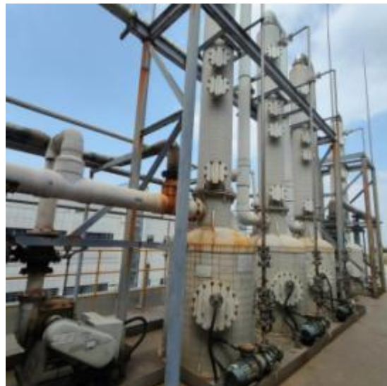
802 车间有机废气预处理设施
